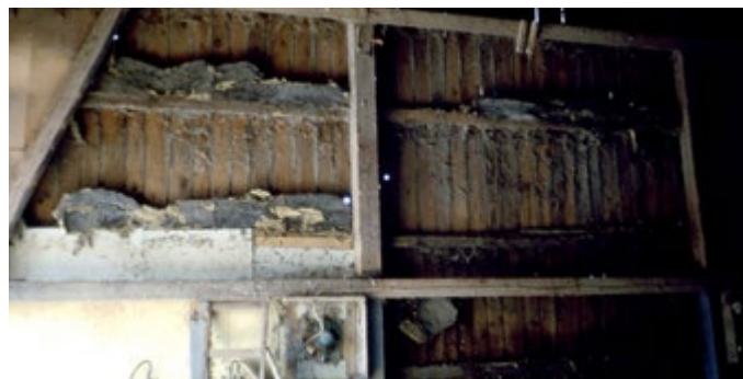
Om råttorna kommer in i en mineralullsisolerad vägg kan det se ut så här bakom väggbeklädnaden efter några år.
